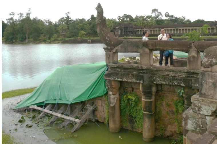
修復対象となる西参道のテラスの様子。現在は崩壊の恐れがあるため、立ち入り禁止になりビニールシートが被せられている。
